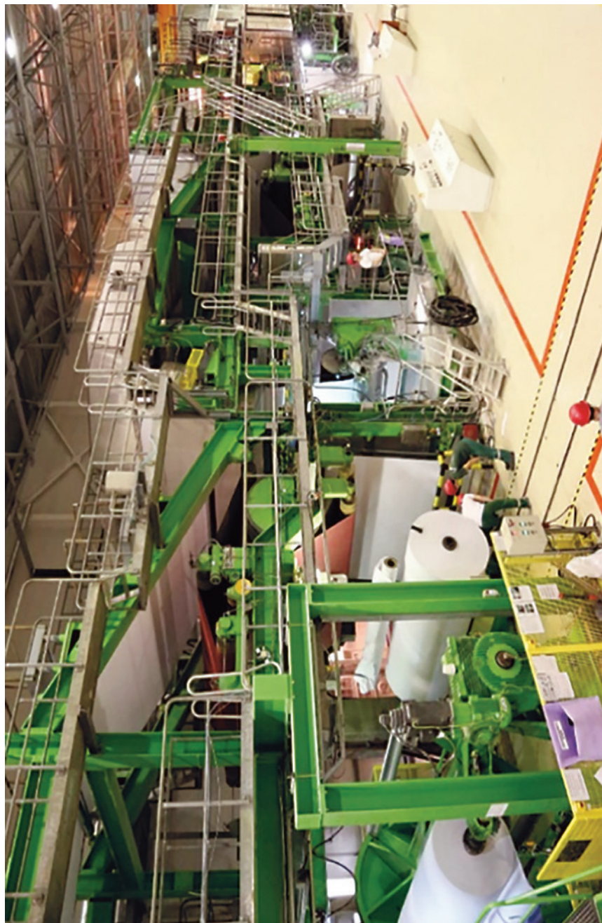
Фото 8. Внешний вид автономной меловальной установки (АМУ)
